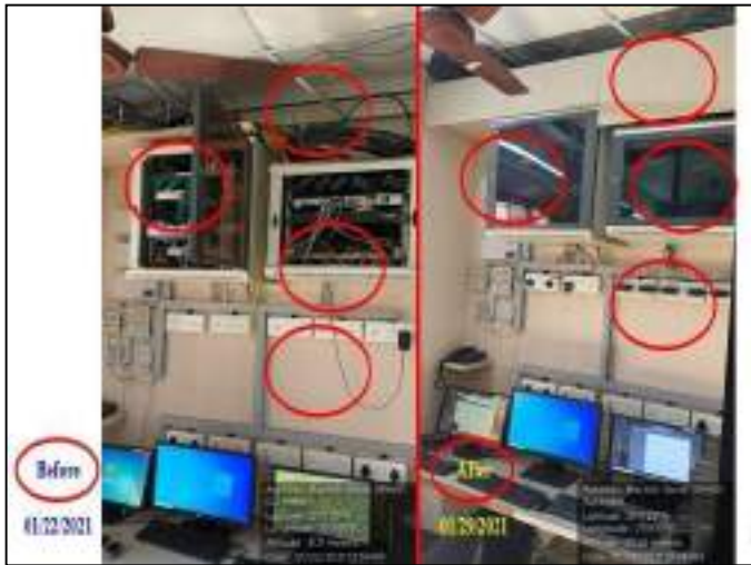
Fig.: Server Room
